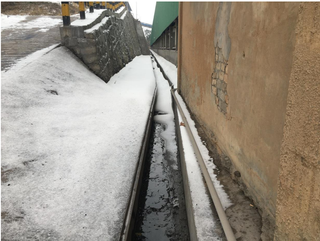
雨水收集管网
