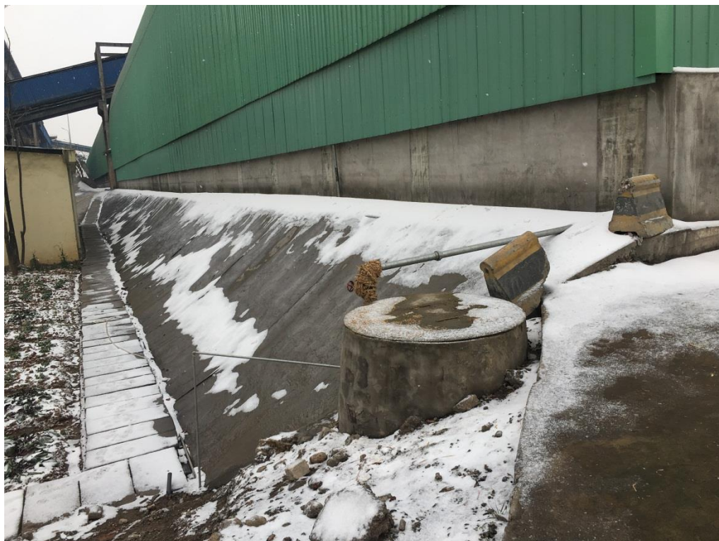
雨水收集管网
